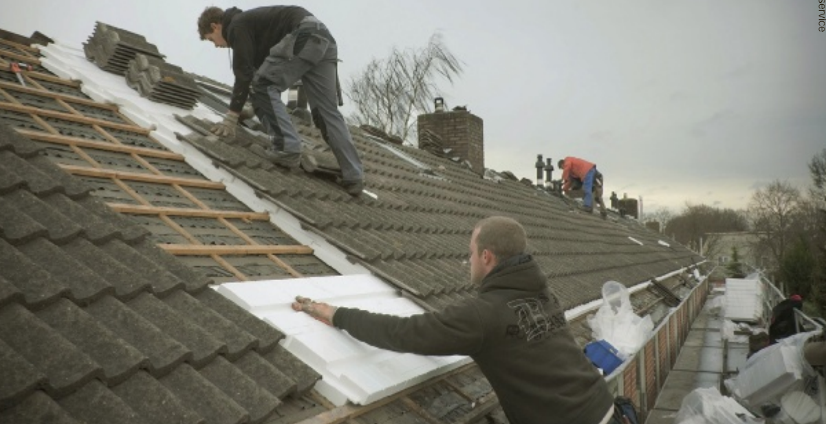
De straatgewijze dakisolatie-campagne in uitvoering, opgezet door Woonservice en huurdersvereniging Samen Sterk (Drenthe).
