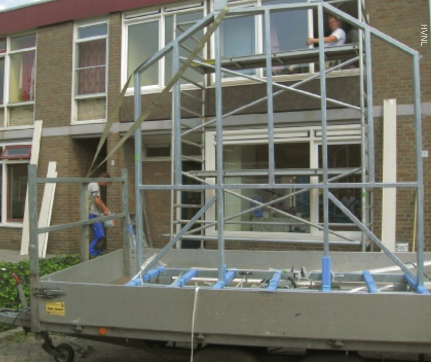
Glaszetters aan de slag in het project van Wonen Limburg in Venray.
